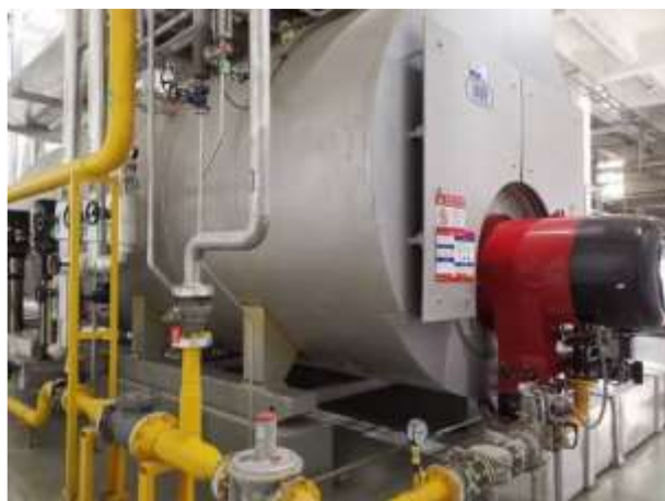
12t/h 燃氣蒸汽鍋爐
